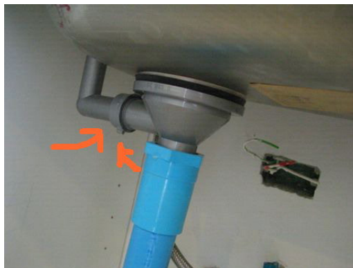
รูปภาพที่ 14 รอยต่างๆของท่อเป็นจุดที่น้ำมักจะรั่วจกบริเวณนี้ถ้าไม่มีการตรวจสอบจะพบภายหลังเมื่อเราเข้าไปอยู่แล้ว
