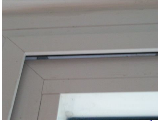
รูปภาพที่ 9 ลักษณะของช่องเปิดที่มีช่องว่างระหว่างบานเปิดกับวงกบซึ่งอาจเกิดจากการติดตั้งที่ไม่ถูกต้องควรจะต้องดำเนินการแก้ไข
