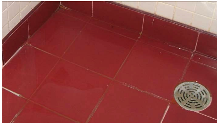
รูปภาพที่ 7 แสดงพื้นที่ในห้องน้ำที่ไม่ได้ระดับและไม่ลาดเอียงเข้าหาช่องระบายทำให้น้ำขังอยู่ตลอดเวลา
