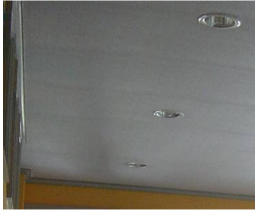
รูปภาพที่ 10 โคมไฟฟ้านอนฝ้าเพดานที่ต้องมีการตรวจสอบการใช้งานก่อนจะลงนามรับบ้าน
